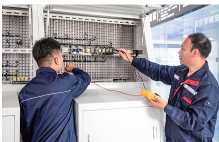
城市轨道交通电气控制演练
